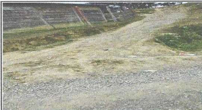
Foto 2: la pared se desprende por falta de repación
