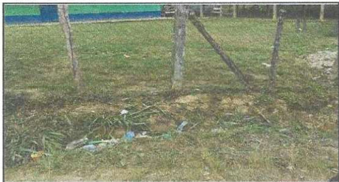
Foto 1: Se observa el desgaste de los postes y la malla
